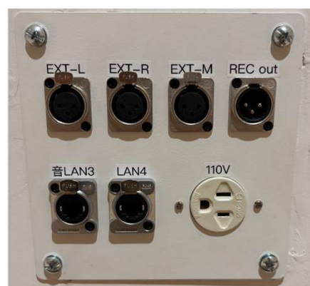
控制室前方訊號面板
